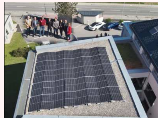
Die neue 17 kWp PV - Anlage auf dem Dach des Gemeindeamtes liefert seit dem Frühjahr grünen Strom
