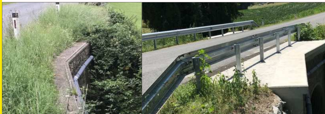
Die Gefahrenstelle vor und nach dem Umbau durch die Straßenbauabteilung des Landes NÖ.
