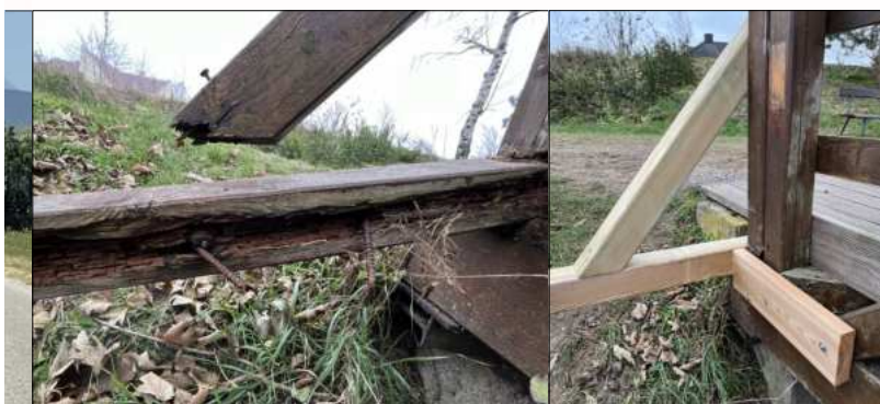
Morsche Bretter und Pfosten bei der Holzbrücke über den Tobelbach vor und nach der Reparatur
